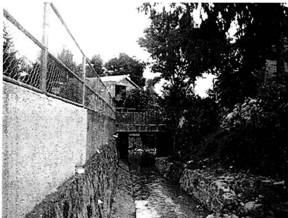
Vista de barranca en el tramo del Andador Durazno flujo de aguas negras a cielo abierto.
