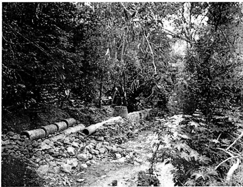
Entubamiento de aguas negras y pluviales hasta el tramo de la Av. Pirules.
