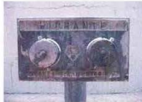
Toma de agua.
