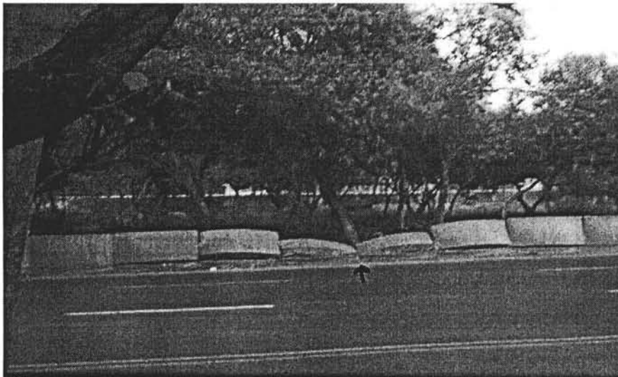
Fotografía No. 6, Hundimiento que se registra en el camellón de la Avenida Cien Metros, México D.F.
