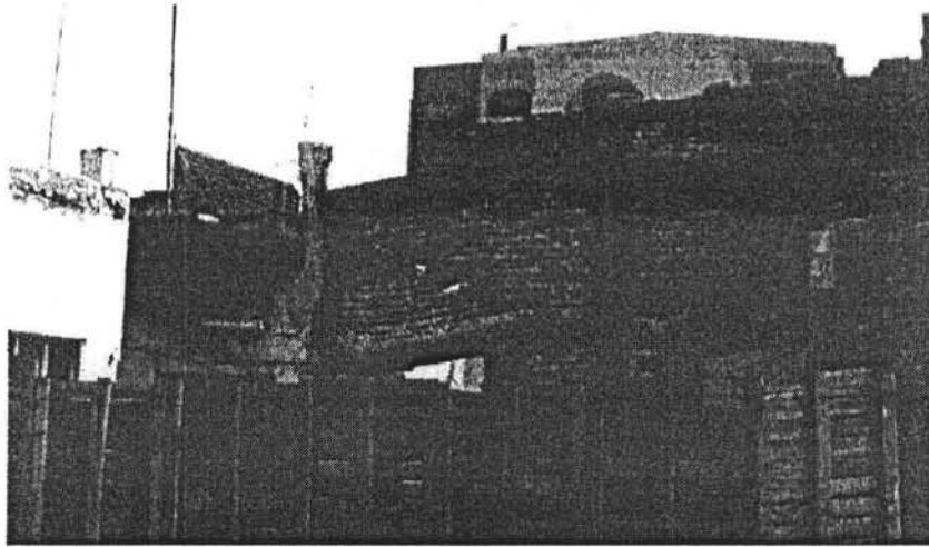
Fotografía No. 11, Parte trasera de una casa habitación ubicada en la calle Narciso Mendoza, la cual se encuentra prácticamente en ruinas y sería imposible poder habitarla, representando un gran riesgo por que en cualquier momento puede haber un colapso provocando algún accidente.
