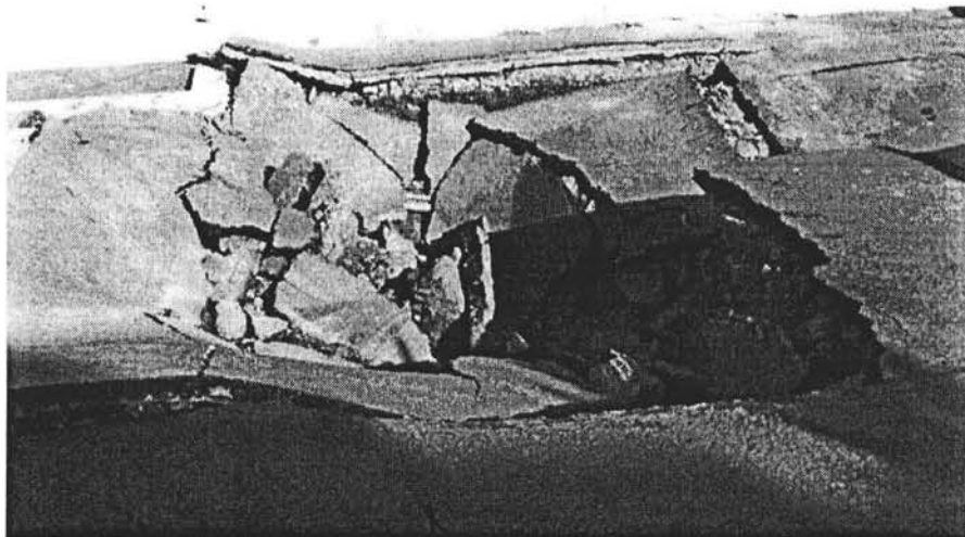
Fotografía No. 2, Después de la subsidencia y el agrietamiento continua el colapso en la calle de Valle de las Nueces de la colonia Valles de Coacalco, Estado de México.
