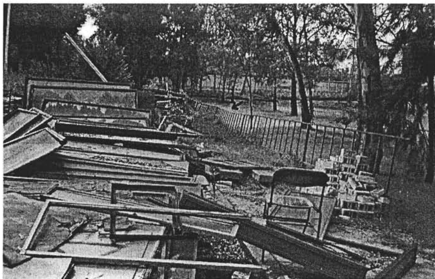
Fotografía No.3, Muestra la subsidencia que se presenta en el patio trasero del Colegio de Ciencias y Humanidades Vallejo, se observan restos del edificio "A" ya demolido.
