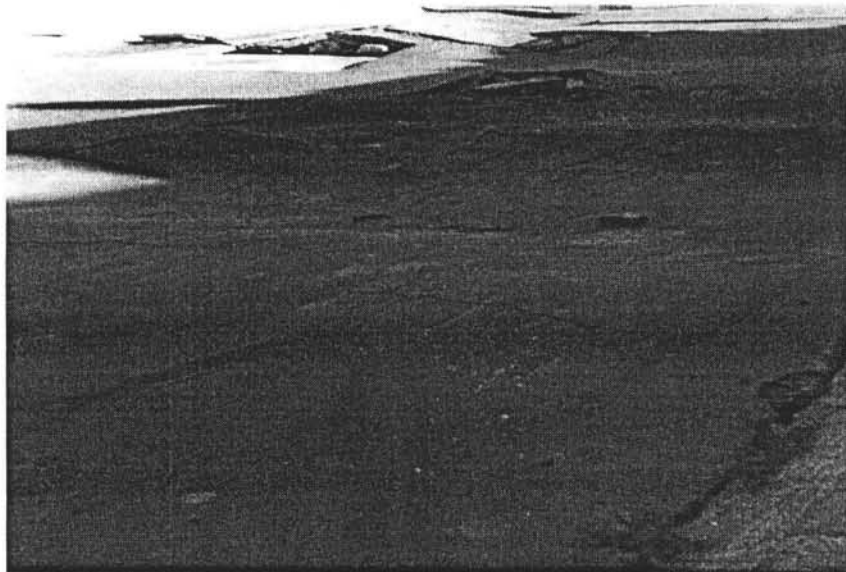
Fotografía No.1, Se observa la subsidencia que sufre la calle de Valle de las Nueces de la colonia Valles de Coacalco, Estado de México.
