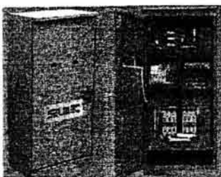
Figura 3.30 Vista Física del circuito de control de transferencia y de paro.
