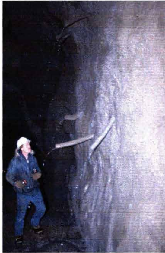
Ilustración 58 Tubos de plástico usados para proveer de drenaje a un talud cubierto con concreto lanzado.
