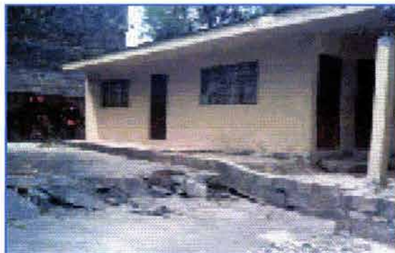
Ilustración 55 Afectación de las construcciones en una ladera inestable. CENAPRED
