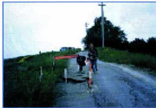
Ilustración 54 Agrietamiento en la corona de un talud. CENAPRED.
