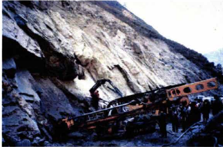
Ilustración 59 Perforación para la instalación de cables de refuerzo en un talud de granito. Ref. 17
