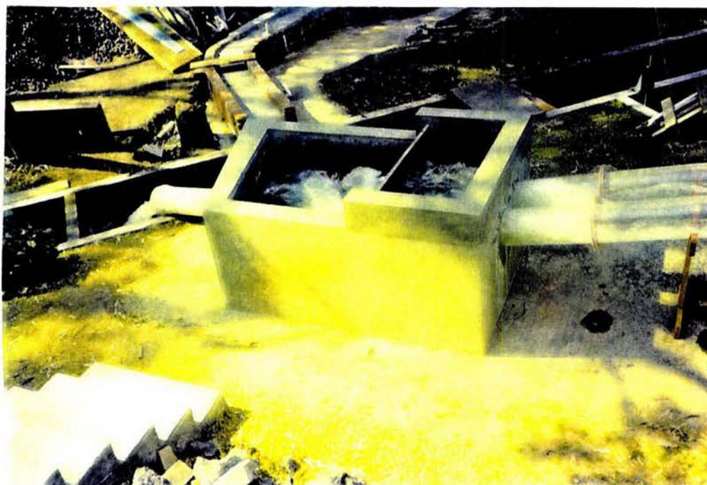
FOTO 12. Vista lateral del tanque de amortiguamiento, aguas abajo del tanque de aguas claras y que conduce el agua hacia el Río Salitre
