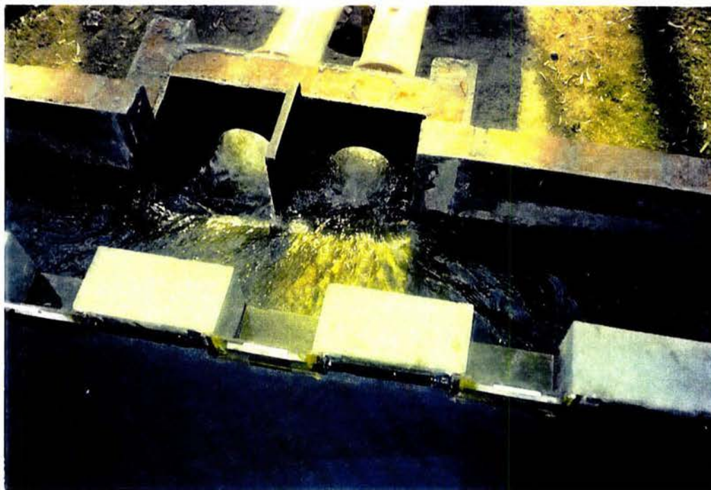
FOTO 11. Detalle del funcionamiento de la caja de captación, que sirve para desalojar el agua del canal de excedencia
