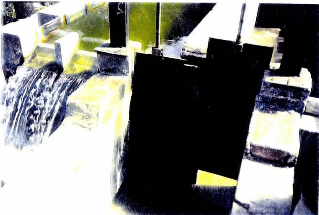
FOTO 9. Detalle de las compuertas que sirvieron para desalojar el agua almacenada en las cámaras.
