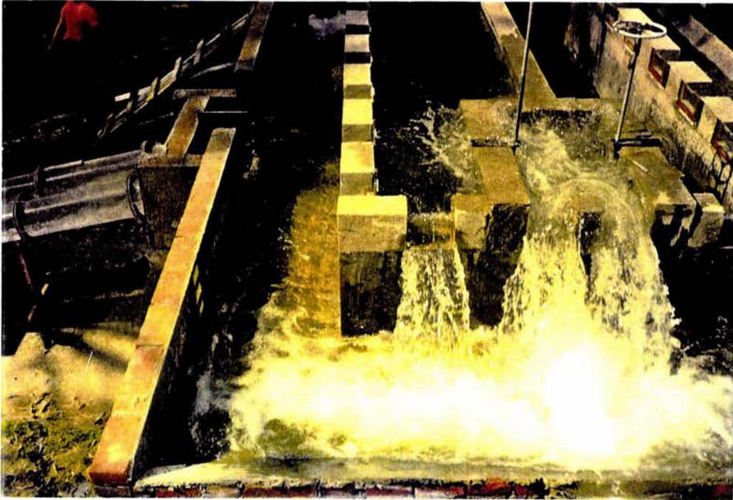
FOTO 8. Funcionamiento de una sola cámara, la cual se encuentra cercana a la caja de captación y tuberías de desalojo
