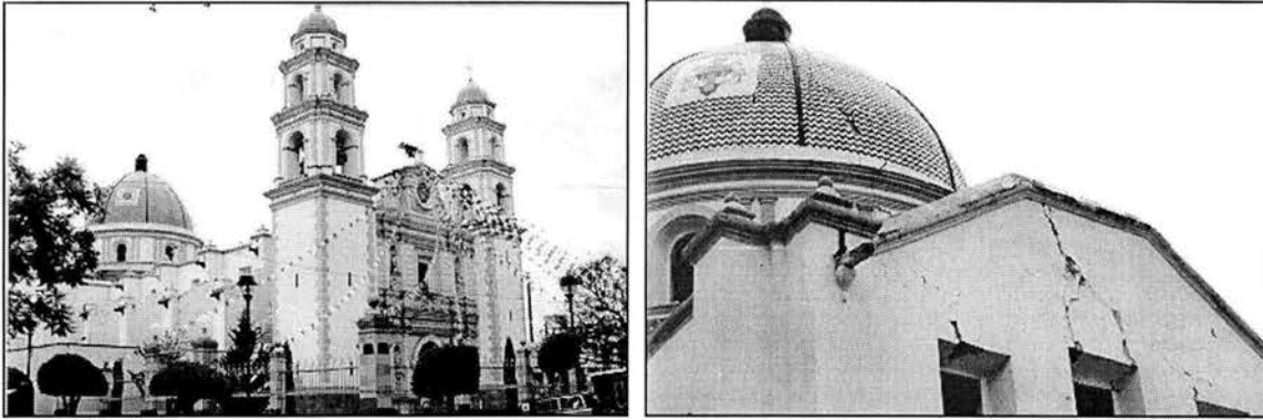
Fotografías 11 (izquierda) y 12 (derecha). Catedral de Tehuacán (fotografía 11), ubicada en la parte sur del Zócalo. Nótese los agrietamientos (fotografía 12) en la cúpula y en el lado poniente de los muros (fotografías de Alcocer et al. , 2002).
