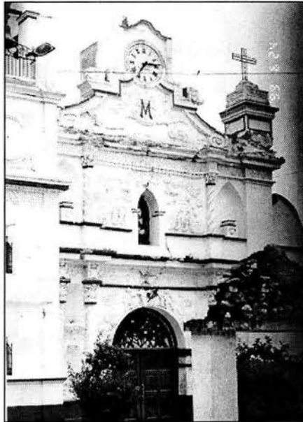
Fotografía 9. Daños en la Iglesia del Calvario, ubicada en la avenida 3 Sur. Nótense grietas en la fachada (fotografía de Alcocer et al. , 2002).
