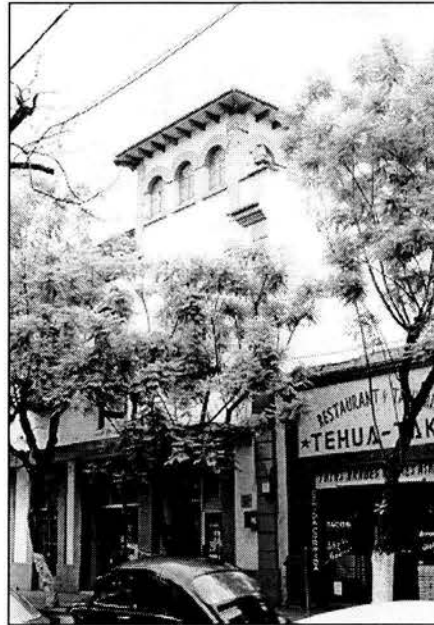
Fotografía 18. Edificio Reforma 113. Obsérvese grieta en los dos apéndices construidos sobre el segundo nivel (fotografía de Alcocer et al. , 2002).
