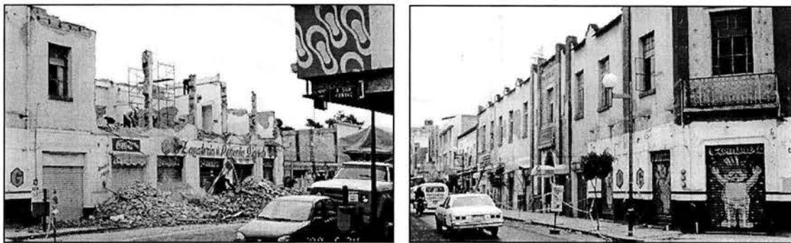
Fotografías 7 (izquierda) y 8 (derecha). Daños en el Hotel Madrid, ubicado en la esquina de las calles 1 Oriente (fotografía 7) y 3 Sur (fotografía 8). Nótense la caída parcial del segundo nivel (sobre la calle 1 Oriente) y el desprendimiento del acabado (sobre la calle 3 Sur) de la fachada principal (fotografías de Alcocer et al. , 2002).
