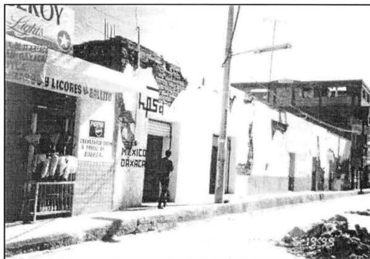
Fotografía 3. Diferencia entre los daños de una vivienda de mampostería bien confinada (izquierda) y otras dos de mampostería sin liga entre muros ortogonales (derecha). Nótese los daños ocasionados por el choque de muros adyacentes (tomada por Lermo et al. , 2000).
