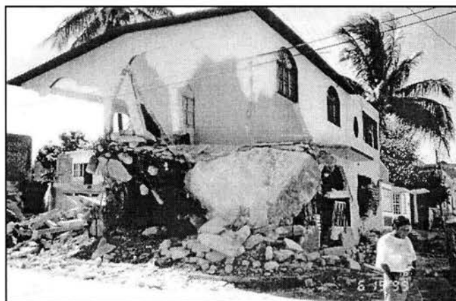
Fotografía 4. Daño en vivienda edificada con adobe y mampostería simple, cercana a la estación 5 (ver figura 48).
