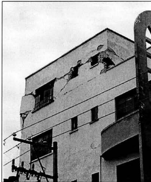
Fotografía 15. Vista del Cine Reforma, ubicado en el centro de la ciudad. Obsérvese daños en el apéndice (fotografía de Alcocer et al. , 2002).
