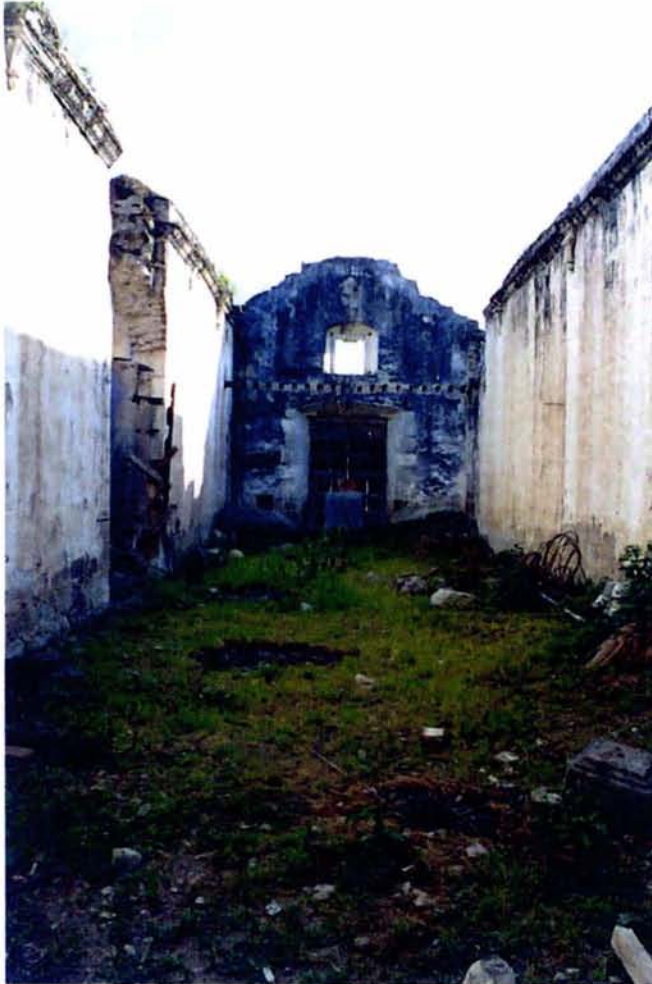
Acumulación de tierra y desperdicios en el interior de la nave descubierta.
