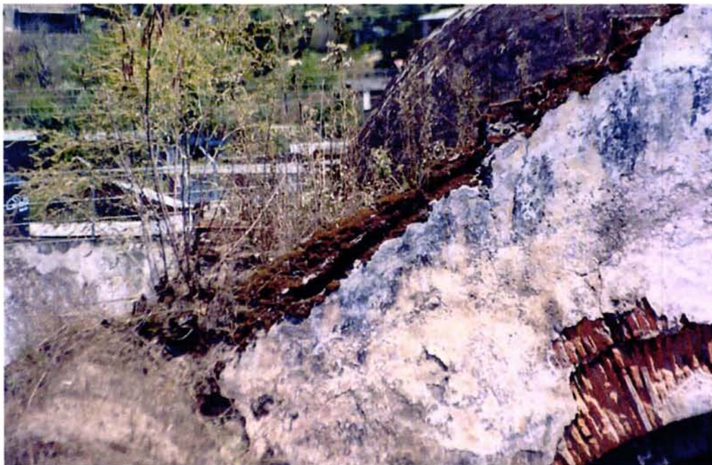
Flora parásita en la cúpula del presbiterio.
