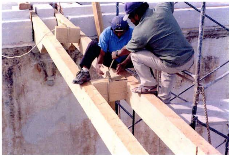
Montaje de los tirantes o tensores en la base de la cubierta.
