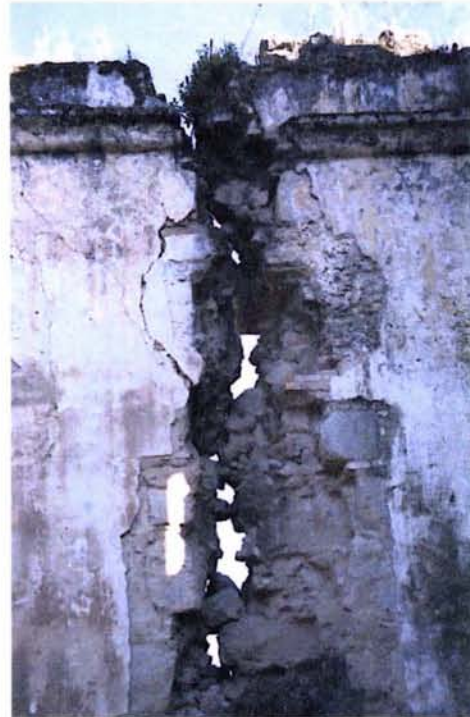
Fractura en la unión del muro de la nave con la torre.
