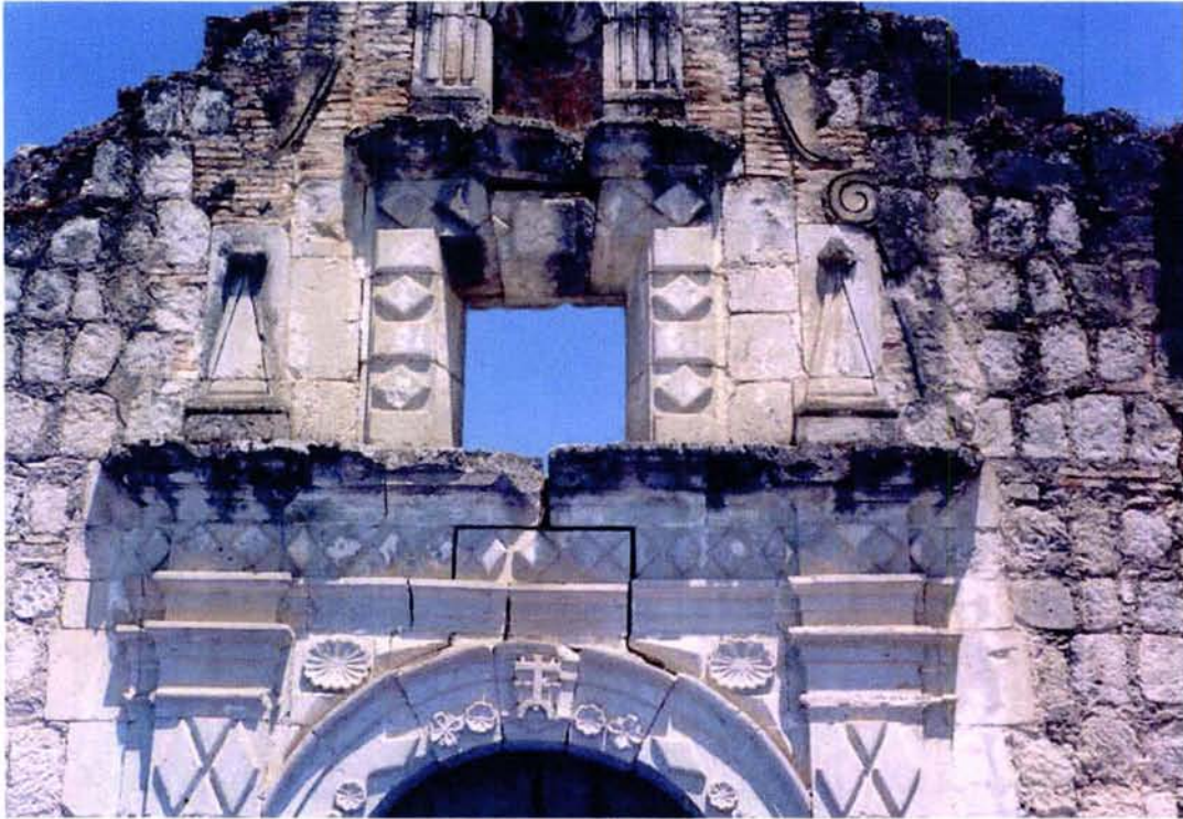
Detalle del deslizamiento de los sillares del entablamento y la arquivolta del acceso principal.
