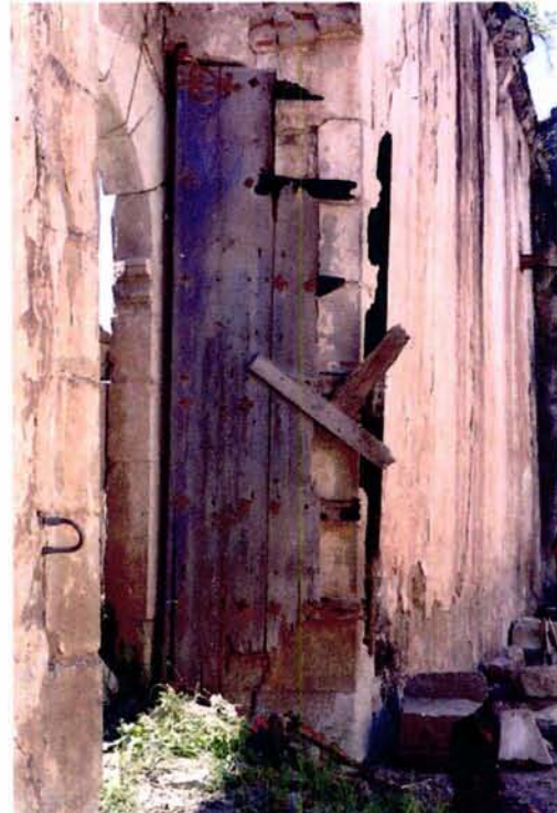
Restos del portón lateral incendiado.
