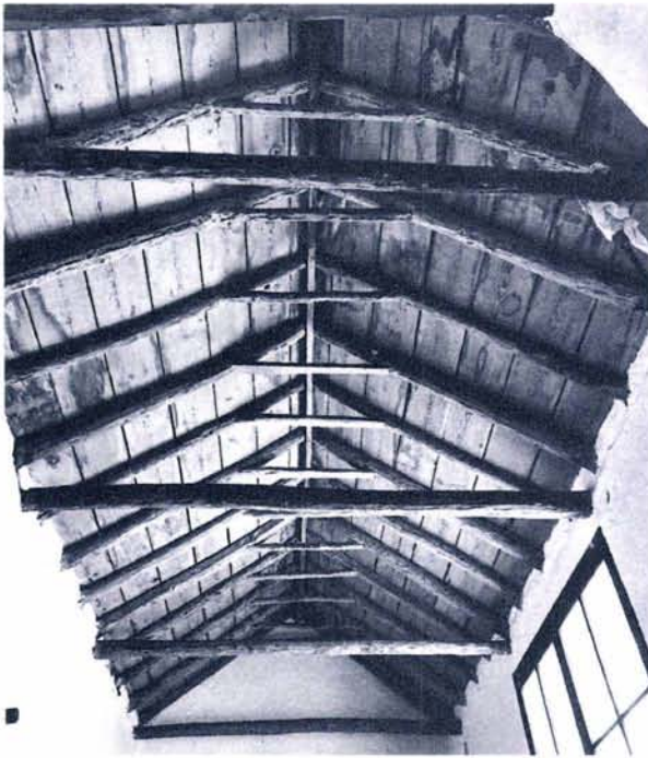
Armadura de cubierta en “par y nudillo” en una casa en Carmona (provincia de Sevilla, España)
