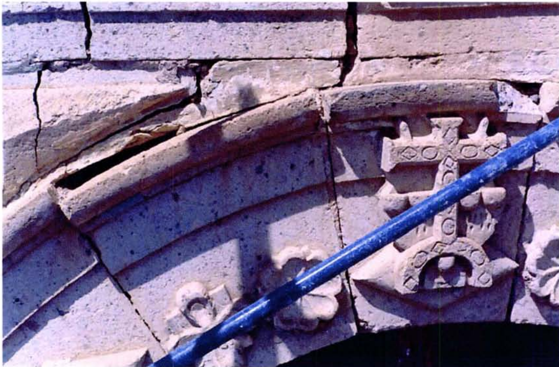
Fractura y deslizamiento de las dovelas de la arquivolta del Imafrente.
