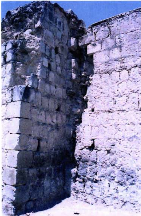
Fractura entre el basamento de la torre y la nave.
