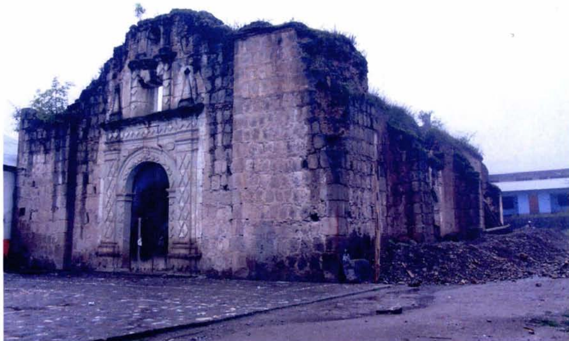
El inmueble en ruinas antes de la intervención del año 2001.
