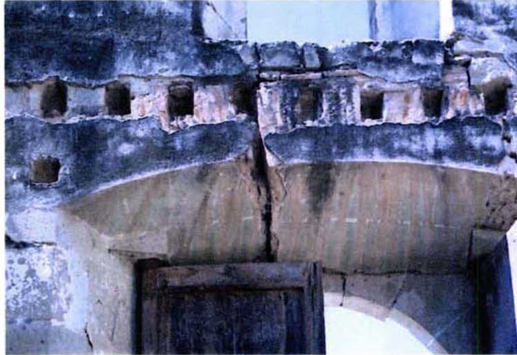
Fractura en el capialzado del acceso principal.
