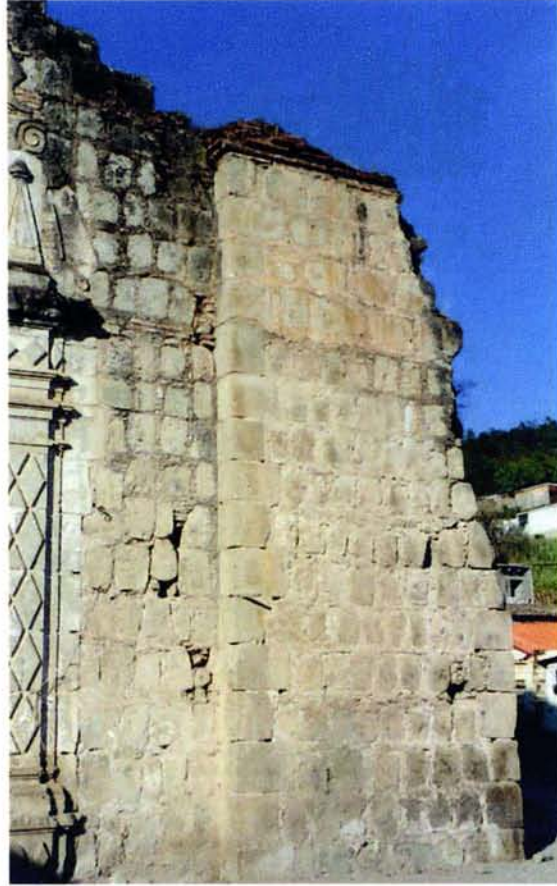
Derrumbe del campanario por el sismo de 1948.
