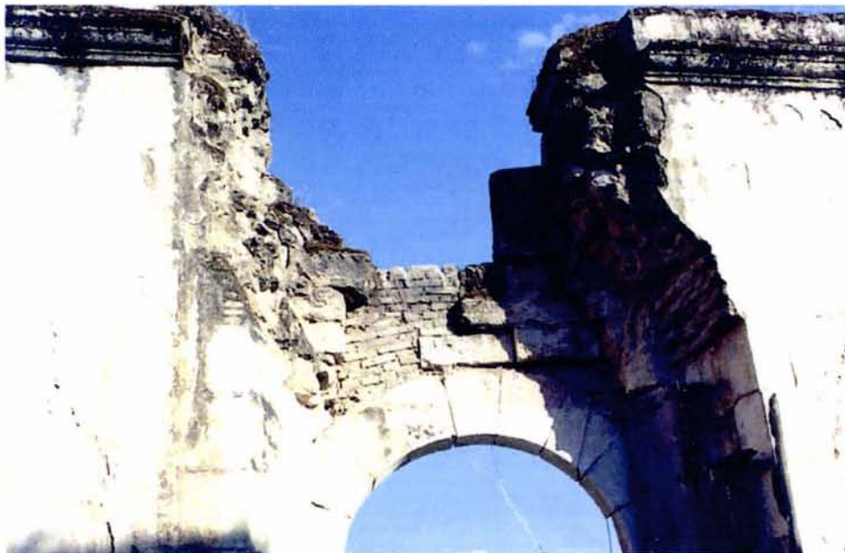
Derrumbe del arco capialzado de la entrada lateral del templo.
