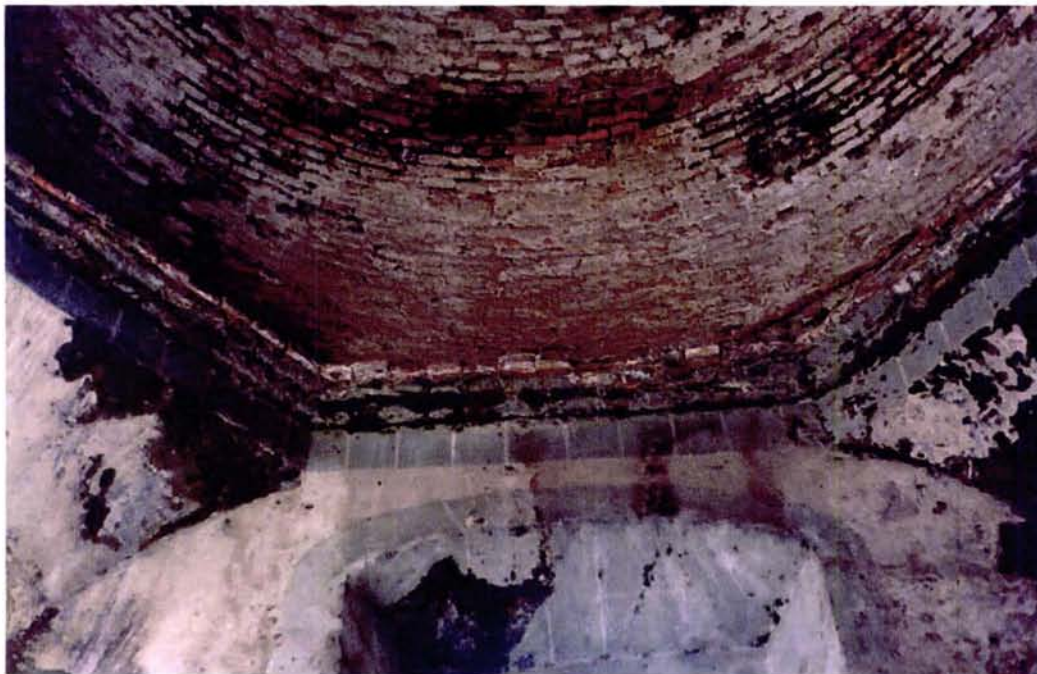
Pérdida de los aplanados por la filtración del agua pluvial. Intradós de la cúpula del presbiterio.
