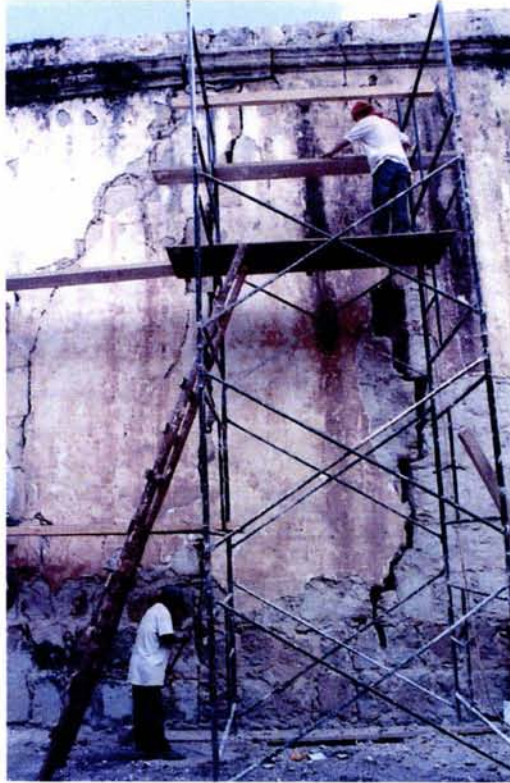
Fracturas en el muro oriente de la nave.
