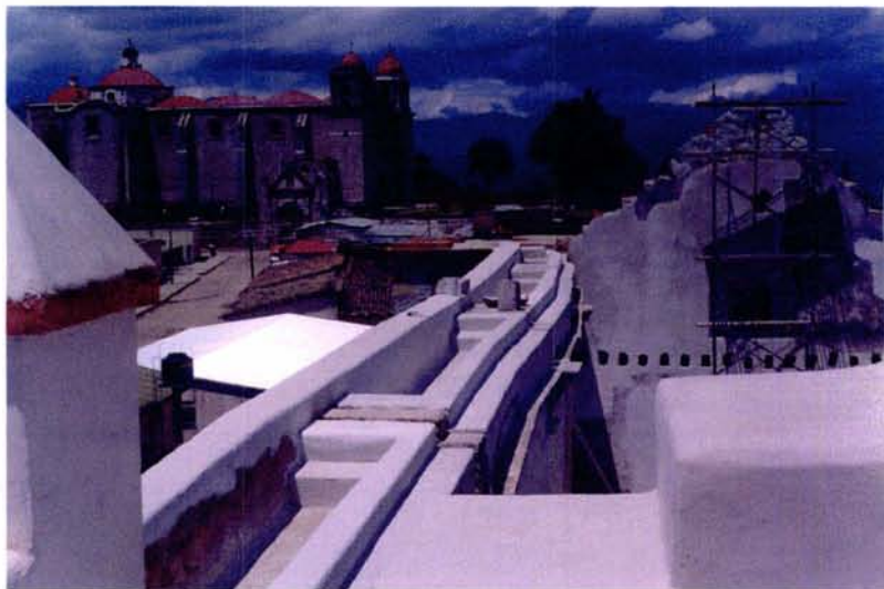
Obsérvese la deformación del muro de la nave.
