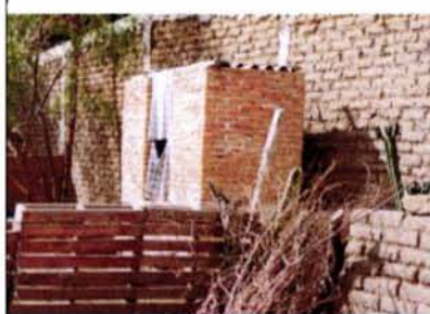
Una de las letrinas secas instaladas en E. Zapata, se encuentra en uso
