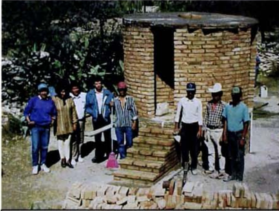
Letrina seca instalada en San Luis Potosí con asesoría del Grupo DESICA
