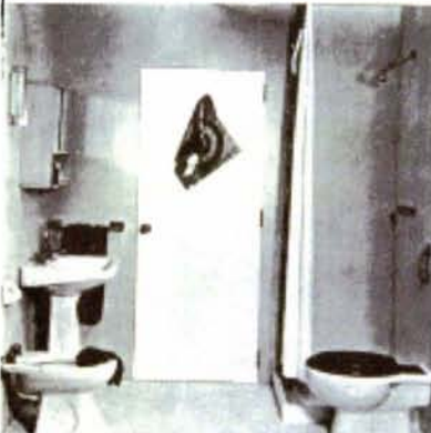
Cuarto de baño con sistema de W.C. de flujo y descarga.
