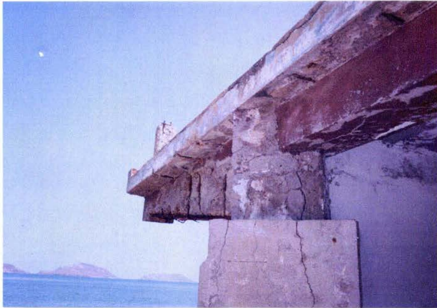
Fig. 4.5. Fotografía de una viga en voladizo dañada por el ataque de sulfatos en un restaurante sobre la playa norte.
