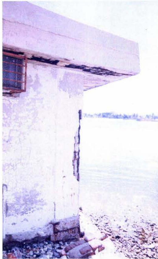
Fig. 4.7. Fotografía una parte de la estructura de la escuela de Ciencias del Mar de la Universidad Autónoma de Sinaloa dañada por los sulfatos.
