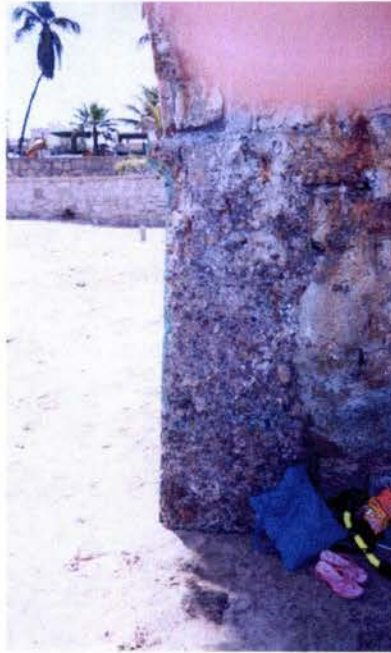
Fig. 4.3. Imagen del daño sufrido por el ataque de sulfatos de un dado de cimentación de un restaurante localizado en la playa norte.
