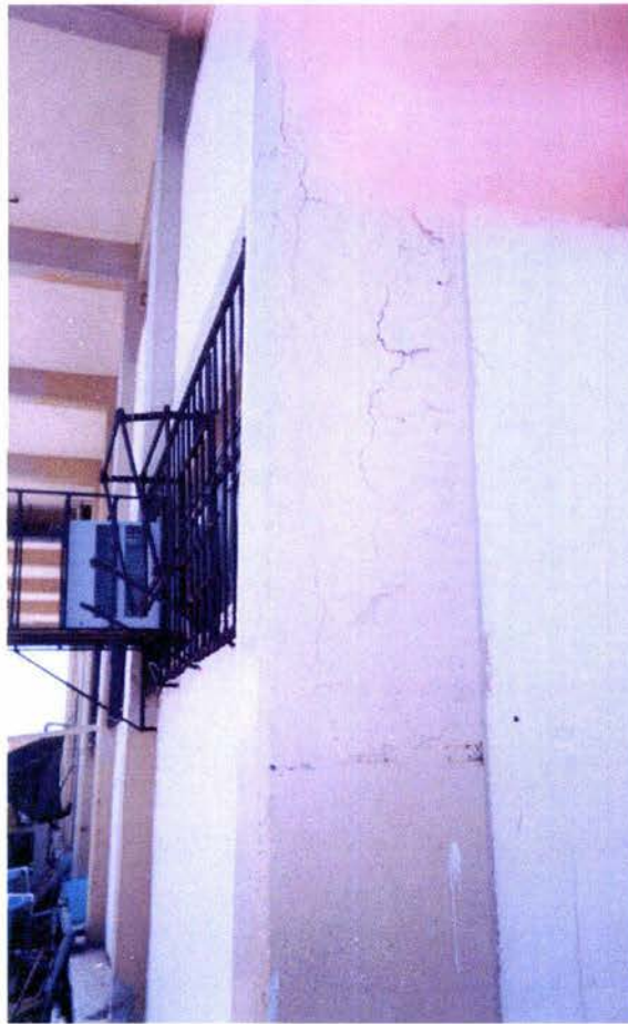
Fig. 4.9. Fotografía la estructura de un edificio de la Escuela de Ciencias del Mar dañada por la acción de los sulfatos.
