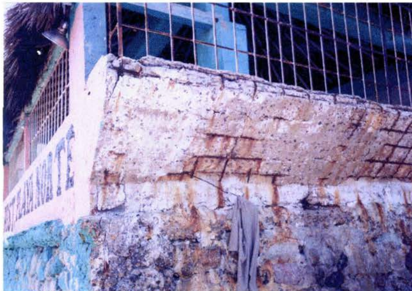
Fig. 4.4. Fotografía del daño sufrido por el ataque de los sulfatos en una ménsula de un restaurante localizado en la playa norte.
