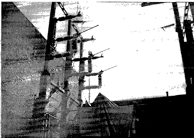
1.1 CUCHILLAS ABIERTAS DEL LADO DE 85KV
