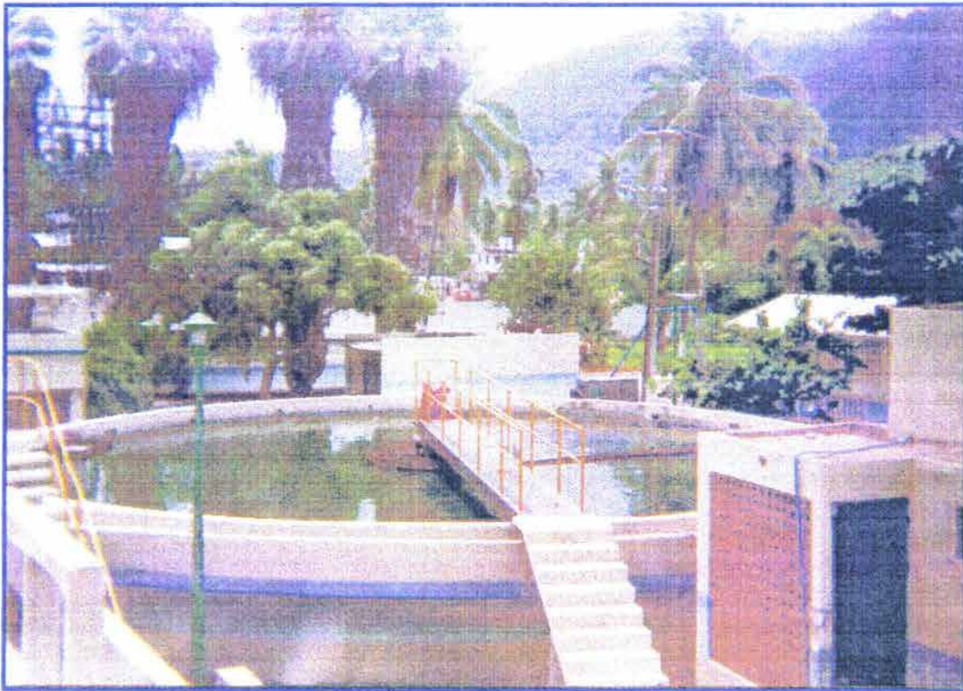
Figura A. Sedimentador de la planta de tratamiento Punta Ixtapa (arriba) y filtro prensa para secado de lodos (abajo).
