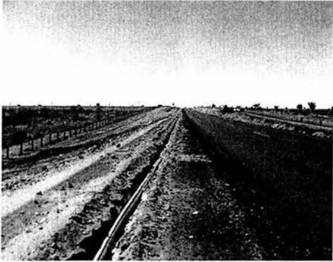
Imagen 1.2.19.- Tendido y colocado de tubería para fibra óptica en el cuerpo nuevo Km 141+500
