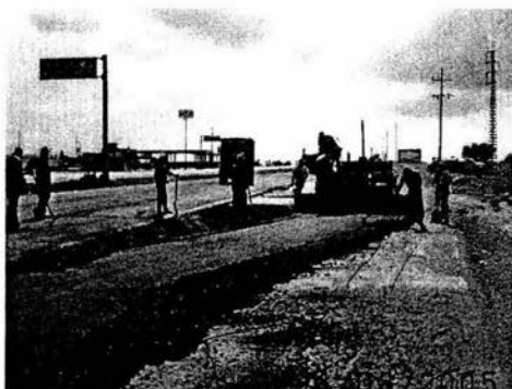
Imagen 3.7.- Tendido de primera capa de base asfáltica en lateral derecha en el km 139+00
