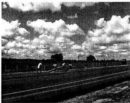
Imagen 1.2.16.-Colocación de tubería para fibra óptica en el hombro izquierdo del cuerpo nuevo ubicado en el Km. 140+100
