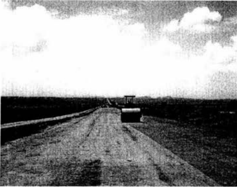
Imagen 1.2.6.-Compactación de capa subyacente en la estación del Km. 142+750 mediante un vibrocompactador.
