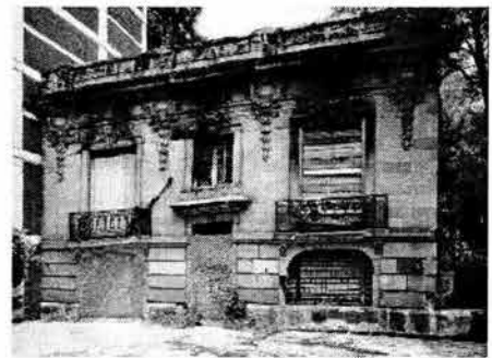
Deterioro en edificios a raíz del sismo, Río de Janeiro 46
