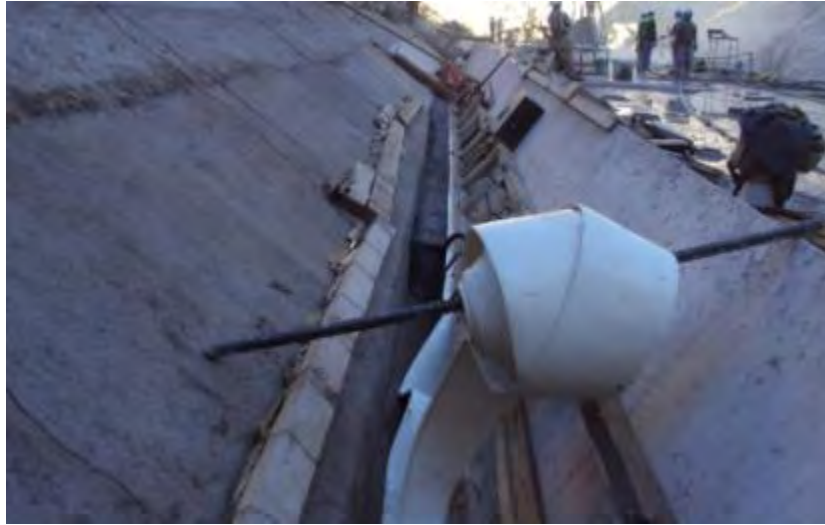
Imagen 6.6-1. Colocación de arena asfáltica y banda de PVC bajo el sello inferior de cobre.
