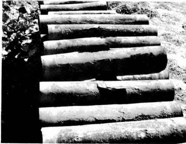
Fig. 30 y 31. DESPUES DE SER SOMETIDOS A CONTINUOS CHOQUES TERMICOS, ESTE ES EL ESTADO EN EL CUAL SE ENCUENTRAN LOS TUBOS DEL HORNO.
