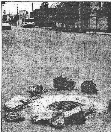
A pesar de que las tapas de los pozos de visita en los decrales son rehabilitados, pero las piedras "protectoras" duran muchos días y han ocasionado accidentes. (Foto Juan Cervantes Jr.)
