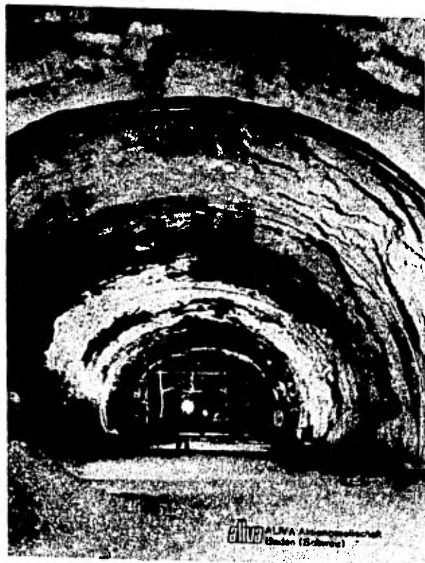
Figura N° I-2 -Distintas etapas en la colocación del revestido primario (concreto lanzado) en un tunel
