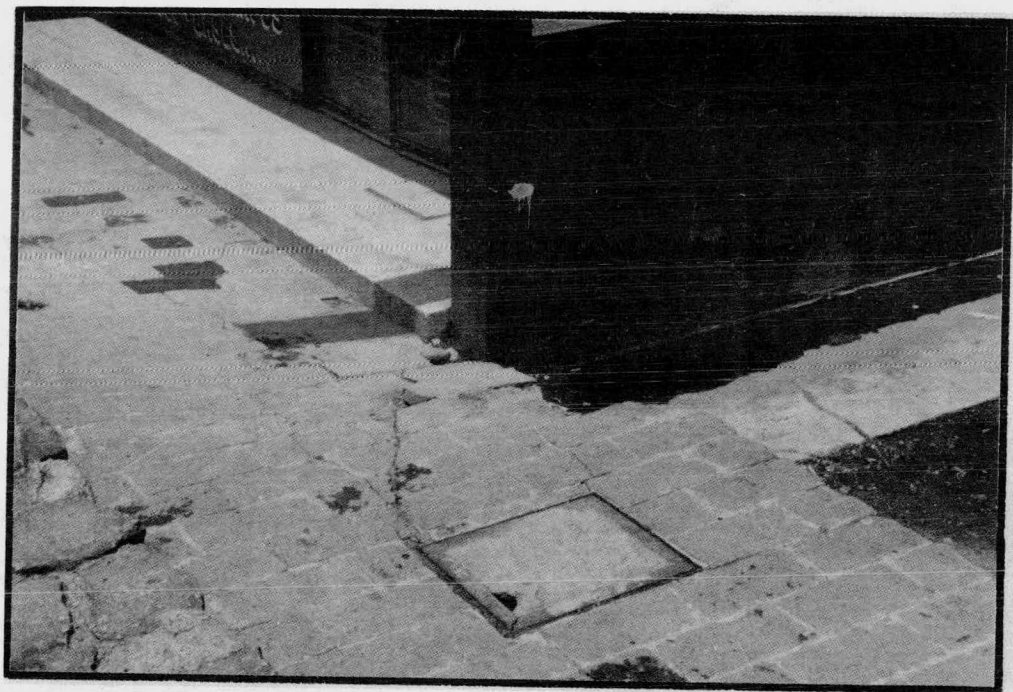
ASPECTO DEL HUNDIMIENTO DE LA ESQUINA SUROESTE
