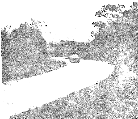
PROTECCION ADECUADA DE LOS TALUDES DE UNA CA- RRERA CON VEGETACION EN UNA ZONA LLUVIOSA, EN EL ESTADO DE CAMPE- CHE. CARRETERA CAYAL - SOZLA.
