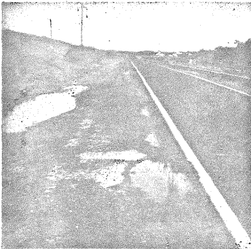
ENCHARCAMIENTO DE AGUA EN EL ACOTAMIENTO, POR FALTA DE UN BUEN BOMBEO EN EL, CON POSIBILIDAD DE INFILTRACION A LAS CAPAS INFERIORES. CARRETERA VERACRUZ - ALVARADO.
