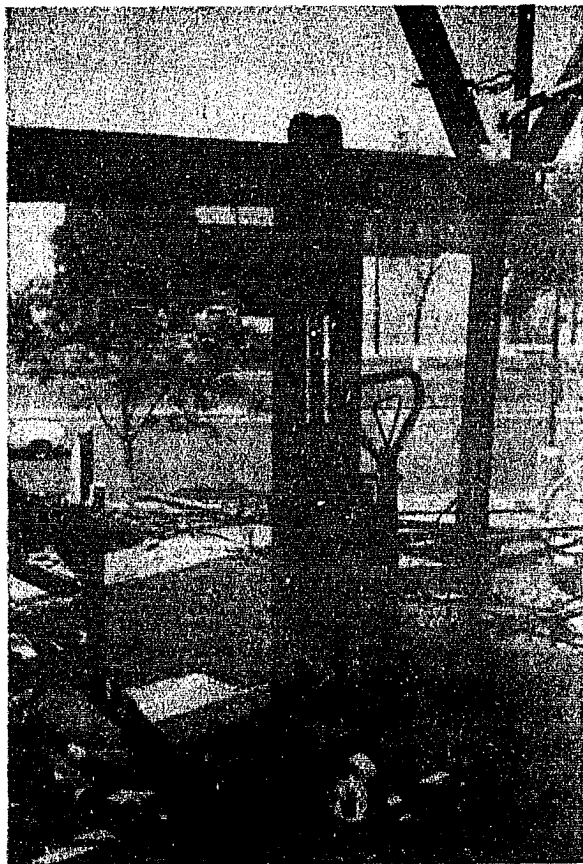
FIG. II.1.3.1. NOS MUESTRA LOS GATOS UTILIZADOS EN EL IZAMIENTO DE LA CIMBRA, LA COLOCACION DE LOS PIES CON SU RESPECTIVO GATO Y ARRASTRE, EN LA PARTE INFERIOR IZQUIERDA DE LA TOMA PODEMOS APRECIAR PARTE DE UN CARRO QUE SIRVIÓ PARA EL TRANSPORTE DE LA CIMBRA.
